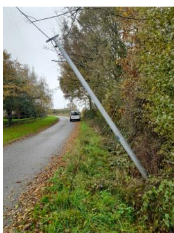
Sécurisation poteau dangereux
