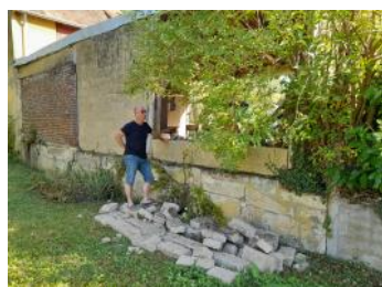
Effondrement de mur
